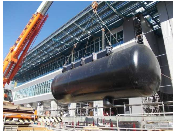
非常用貯水槽※
