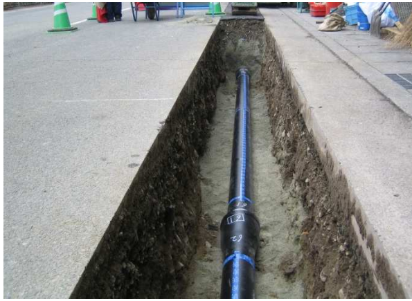
管路の耐震化
