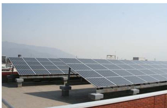
太陽光発電の導入（上下水道局庁舎）
