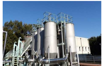
砂ろ過塔（処理水の再利用）
