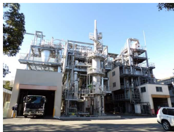
甲府市浄化センター汚泥焼却施設
