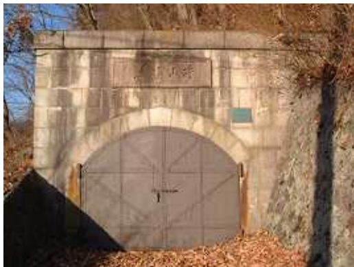
平瀬浄水場旧片山隧道下口 築造年：大正2年 登録原簿登録日：平成10年9月2日
