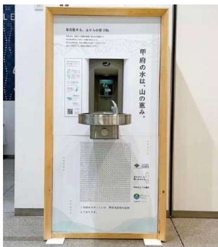
給水スポットの設置（甲府市役所） （6月1日）
